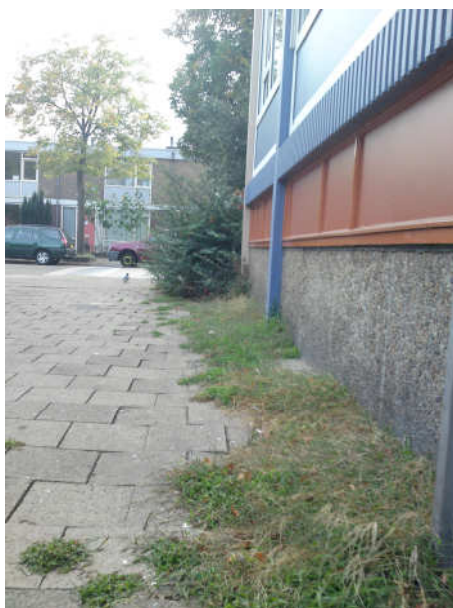
Veel onkruid tegen de gevel, slechte kwaliteit van het stoepetegelwerk.
